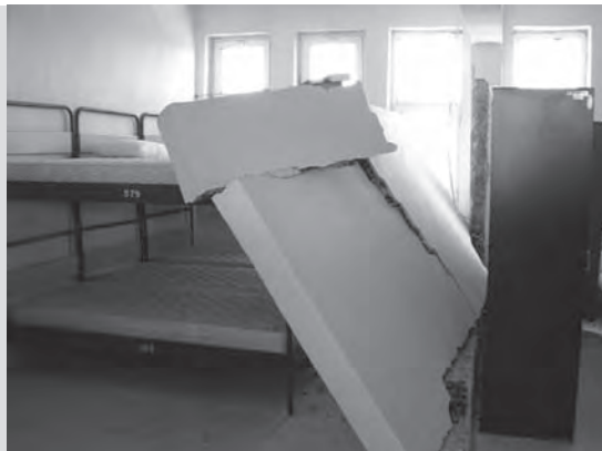
تخریب تیغه جداساز در اثر زلزله
