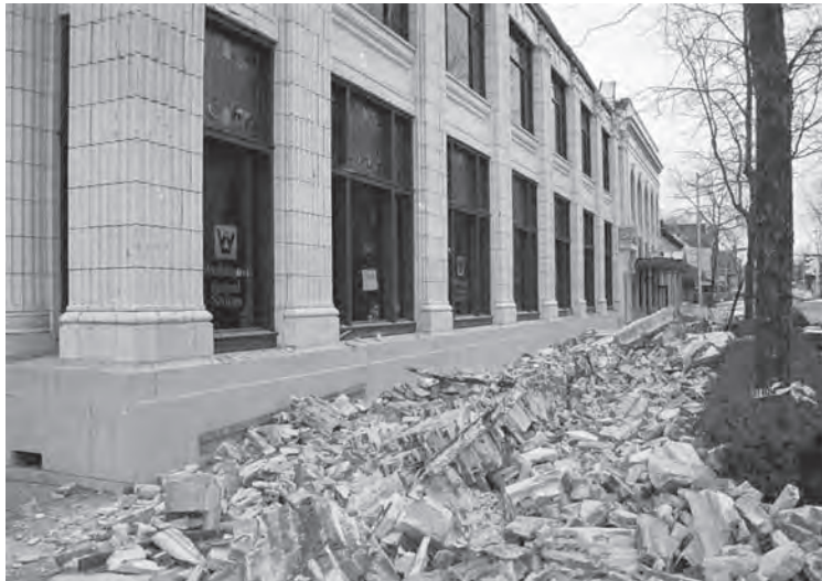
تخریب جان‌پناه در زلزله و ریزش آوار حاصله در خیابان
