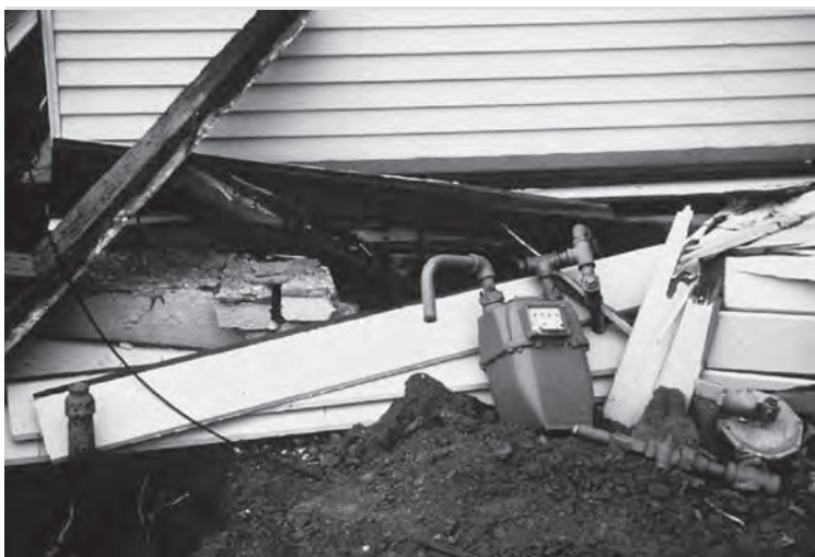
نمونه‌ای از خسارات وارد شده به لوله‌های گاز در زلزله
