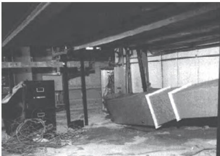
کنده شدن کانال هوا از سقف در اثر زلزله و سقوط آن به پایین
