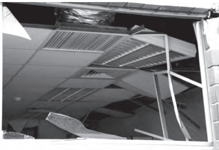
جدا شدن دریچه پخش هوا از سقف در اثر زلزله
