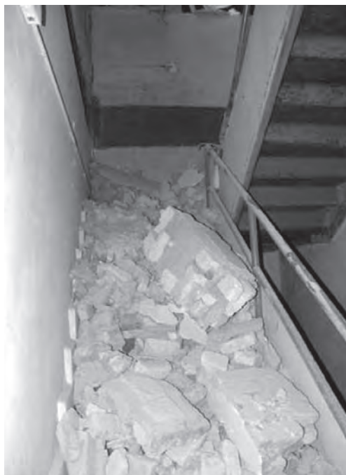
ریزش آوار ناشی از تخریب دیوارهای پیرامونی پلکان در زلزله ۱۳۸۵ لرستان
