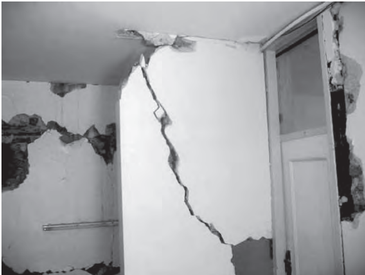
خسارات وارد شده به تیغه‌های بنایی در زلزله ۱۳۸۵ لرستان
