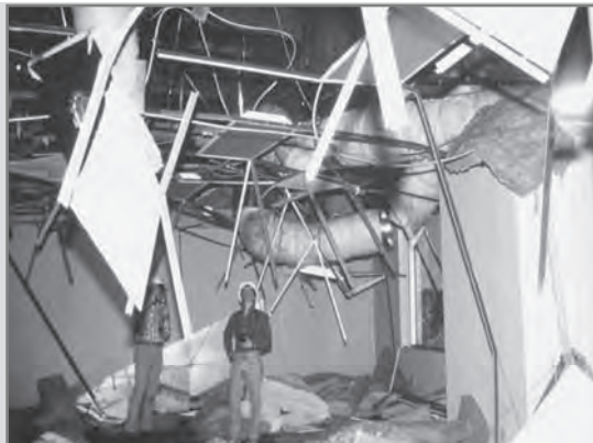
تخریب کامل سقف کاذب و چراغ‌های سقفی در اثر زلزله
