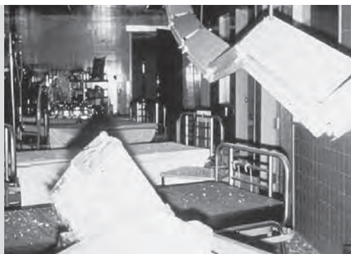
تخریب سقف کاذب و چراغ‌های سقفی بیمارستان در اثر زلزله
