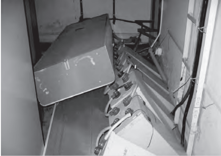
واژگونی باتری‌های مربوط به ایستگاه تلفن همراه دوجیانگیان در اثر زلزله ۲۰۰۸ چین
